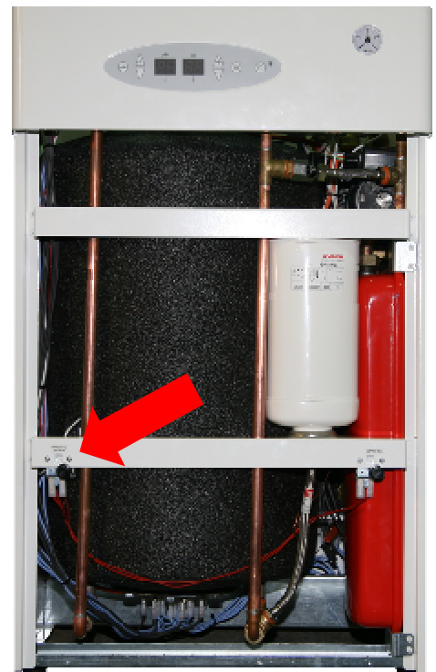
Situación del limitador de A.C.S. en una caldera GMXP
