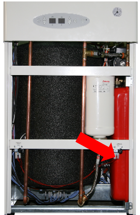
Situación del limitador de calefacción en una caldera CMXP
